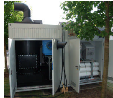
CH 4 -Tankstelle als Bestandteil der Gesamtanlage. Bildquelle: Specht
